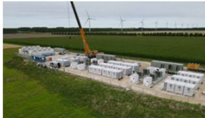
Figuur 5 - Twee grootschalige gridbatterijen van Giga Storage: links de Giga Rhino (2020, 12 MW/7,5 MWh) en rechts de Giga Buffalo (2022, 25 MW/48 MWh) Bron: Giga Storage
