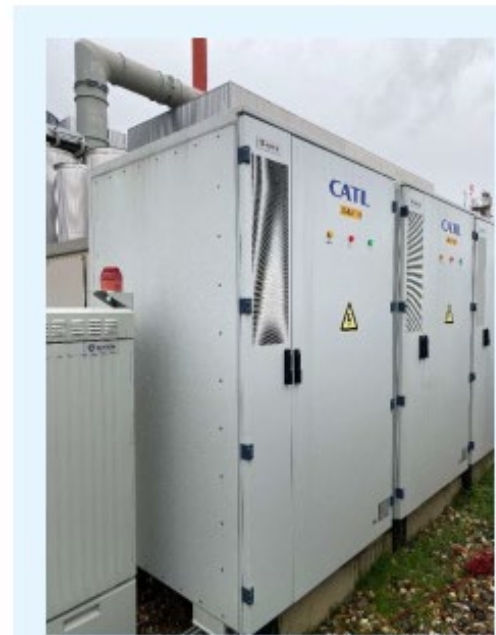
figuur 10: voorzijde battery rack
