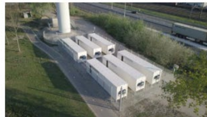
Figuur 3 – Batterijen van totaal 10 MWh bij windpark Hartelkanaal van Greenchoice Bron: Alfen
