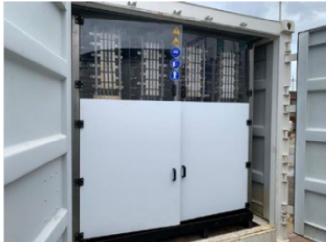
Figuur 7 - Zoutwaterbatterij van AquaBattery met 1 kW/7 kWh 21
