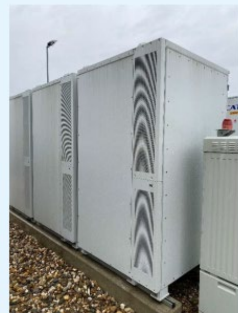
figuur 11: achterzijde battery rack
